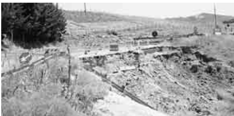
La frana sulla statale 117 provocata dal crollo
