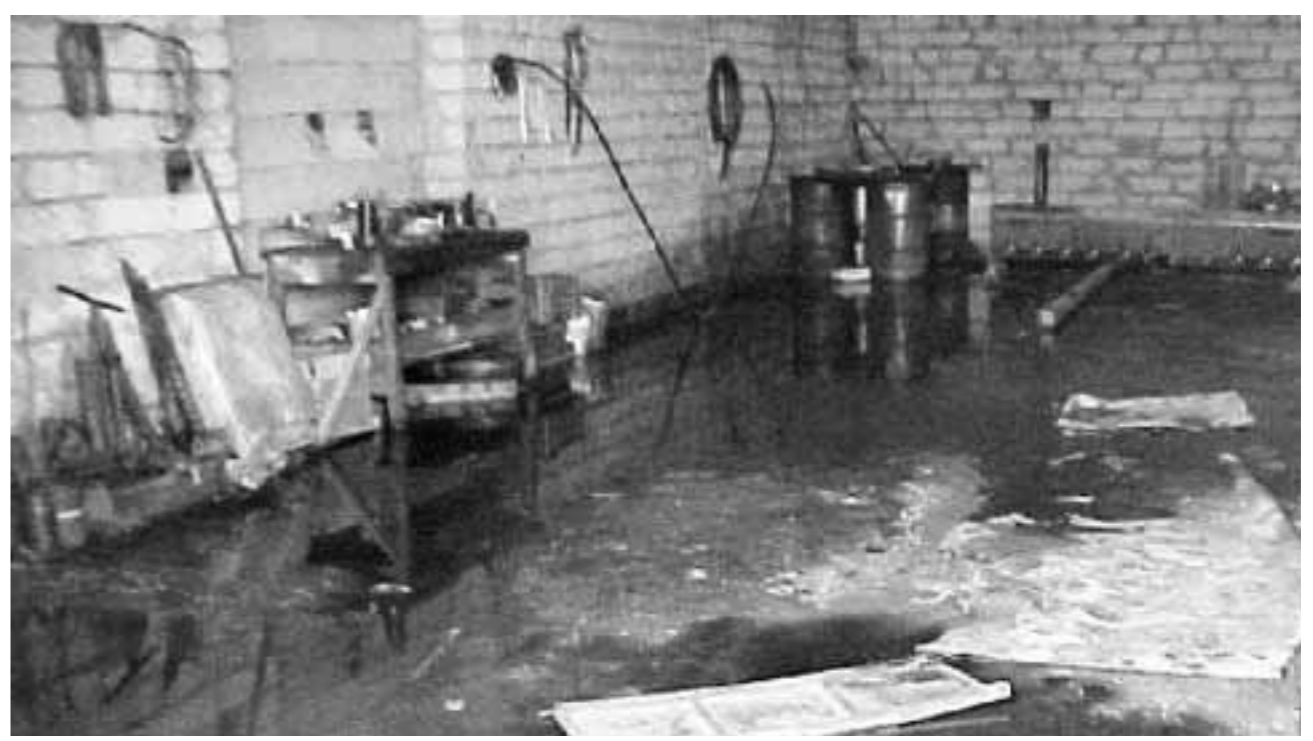
UN GARAGE DI VIA MASCAGNI INVASO DAI LIQUAMI FUORIUSCITI DALLA RETE FOGNARIA E PRATICAMENTE INUTILIZZABILE DA DIVERSO TEMPO
