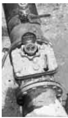
UNA CONDOTTA IDRICA
